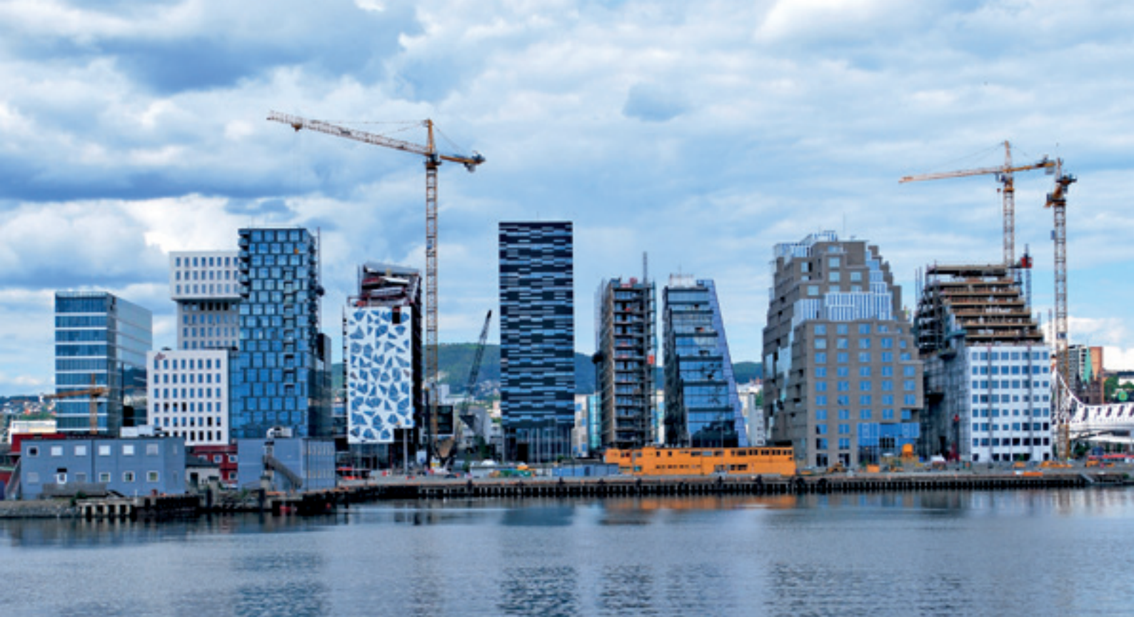
Rikdommens bydel. Fra byggingen av Barcode i Bjørvika, 2012. Foto: Helge Høifødt/Wikimedia Commons
